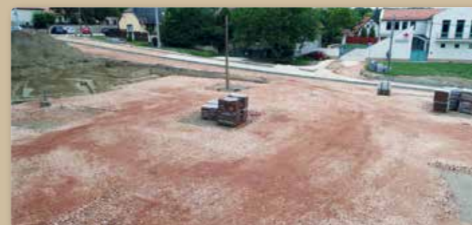
A Piac tér és környezetének építése is jól halad, már kirajzolódik az elsőként elkészülő út nyomvonala, valamint a tér sziluettje is.
